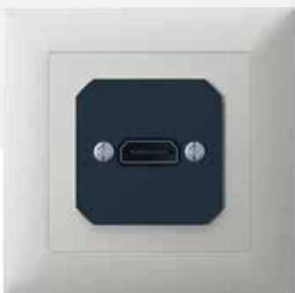
HDMI csatlakozóaljzat, elővezetékezett
