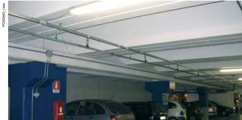
Canalis „KBA” ellátó lámpatestek sprinklerok közelében.
