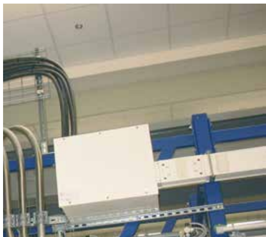
Canalis KS és sprinkler
